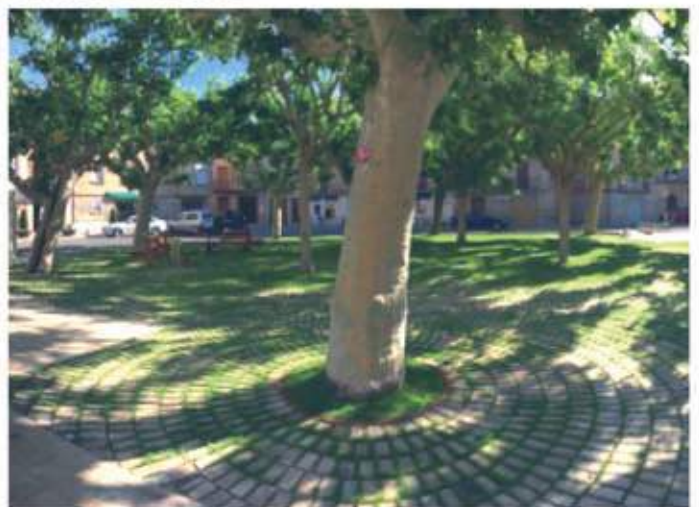
• Els serveis de jardineria de Talma han fet la reconstrucció de la Plaça de la Vila. L'obra s'ha realitzat en 5 setmanes i ha consistit en tallar les arrels superficials dels arbres, canviar-ne la terra, arreglar les llambordes del terra, renovar l'equipament existent i adaptar els accessos.
